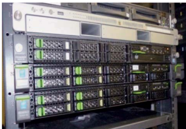
写真-1 コンテンツサーバー (LMS用、データベース用)
