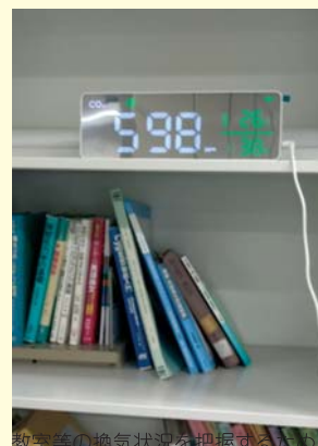
教室等の換気状況を把握する為に導入されたCO2センサー
